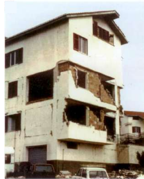
Bow-window: Espulsione delle tamponature per mancanza di collegamenti verticali.
