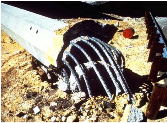
Inadeguata connessione tra pila e fondazione di un viadotto
