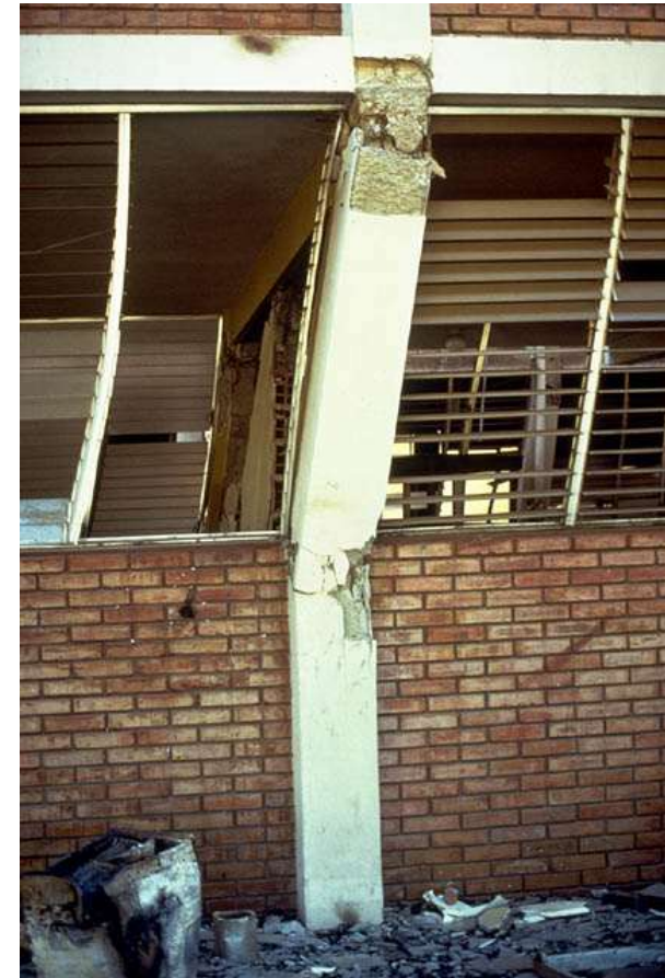
“Pilastro snello” (rottura a flessione)
